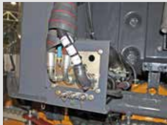
À partir des points de raccordement facilement accessibles, les techniciens procèdent plus rapidement à la recherche des incidents.
